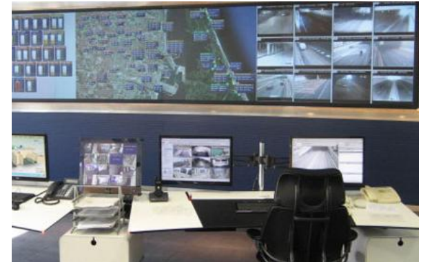
Panel de control del ciclo integral del agua en Valencia
